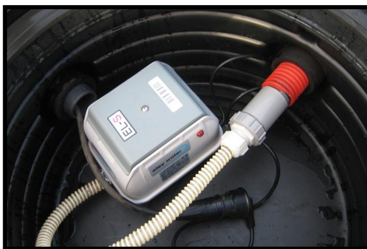
Figure 7-10: Raccordement électrique en local technique pour les Oxyfix 4, 5 et 6EH
